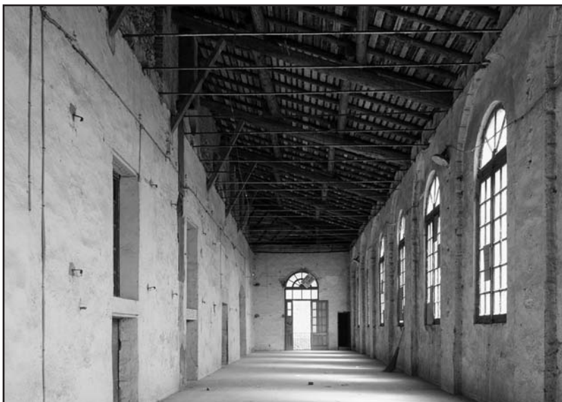
Loggiato superiore di Palazzo Secco. Su alcune travi a vista sono visibili le tracce degli incendi passati. (BAMS - Matteo Rodella)
